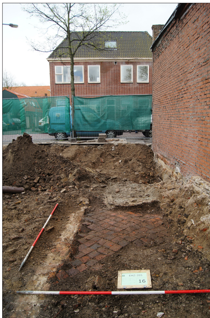
Afb. 15 De sporen van het huis op het westelijke perceel uit ca. 1591, kijkend richting de Westerstraat. Links ligt de zijmuur (S19) van het pand en in het midden de plavuizen vloer (S23).
