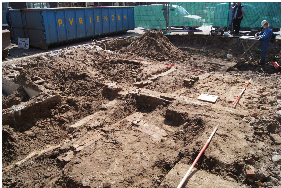
Afb. 30 Vlak onder het maaiveld lag een wirwar aan muren, daterend uit de 17de-19de eeuw, kijkend richting de Westerstraat.
